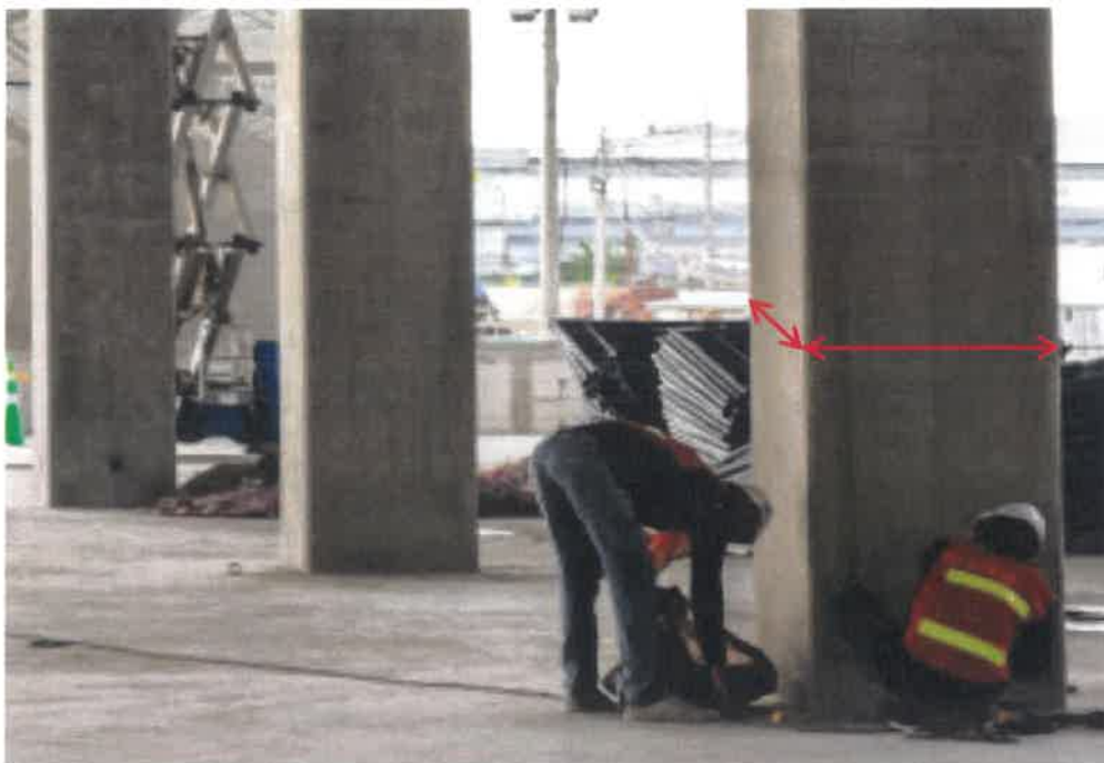
ภาพที่ 5 เก็บข้อมูลขนาดของโครงสร้างเสาตรวจสอบกับแบบก่อสร้าง
